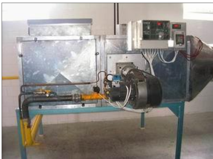
Zdroj teplého vzduchu
